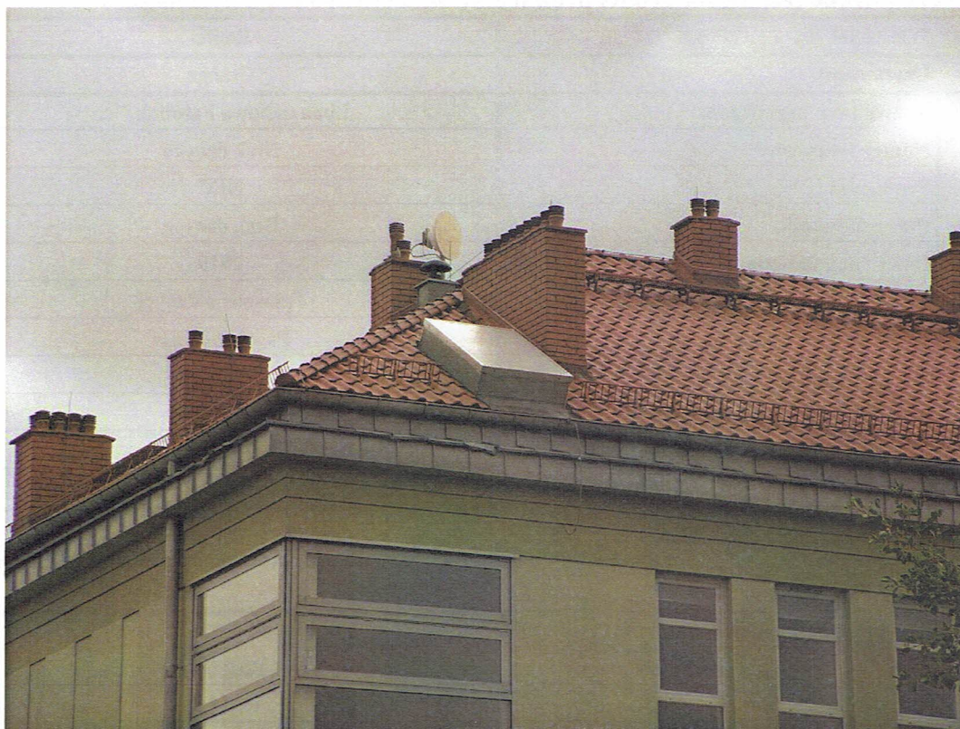
Fot. 1. OM Włoszczowa / ul. Kusocińskiego 11 – widok anteny na dachu budynku
