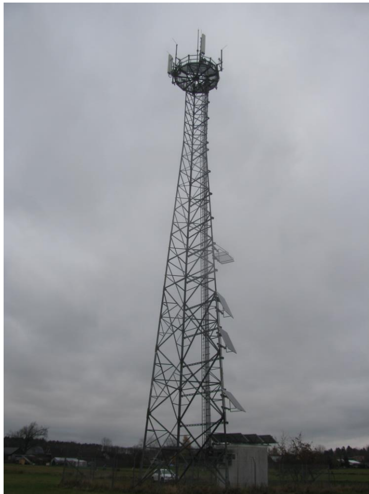
Zał. nr 1: Widok ogólny instalacji radiokomunikacyjnej.
